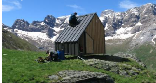
Opération annuelle de mise en marche
